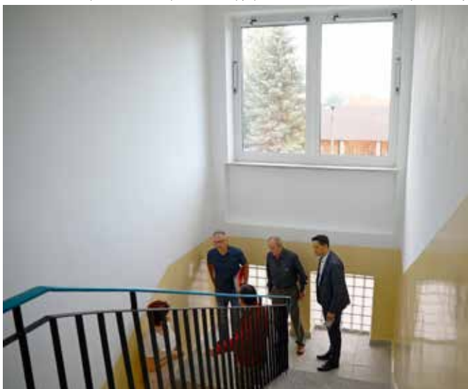
Dostosowana do wymogów ppoż. klatka schodowa w ZSP w Uściu Solnym
