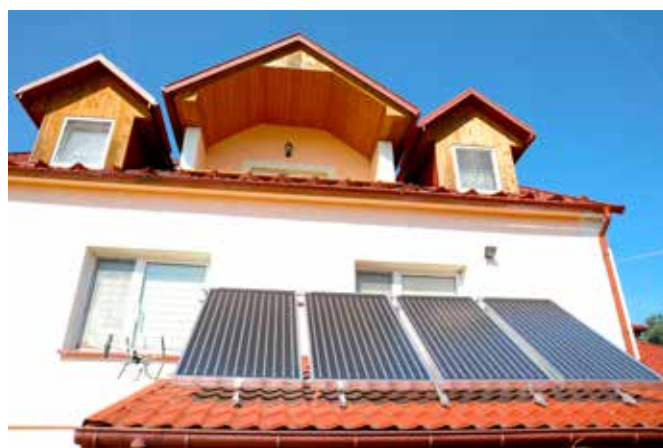
Jedna z zamontowanych, kilkunastu instalacji kolektorów słonecznych
