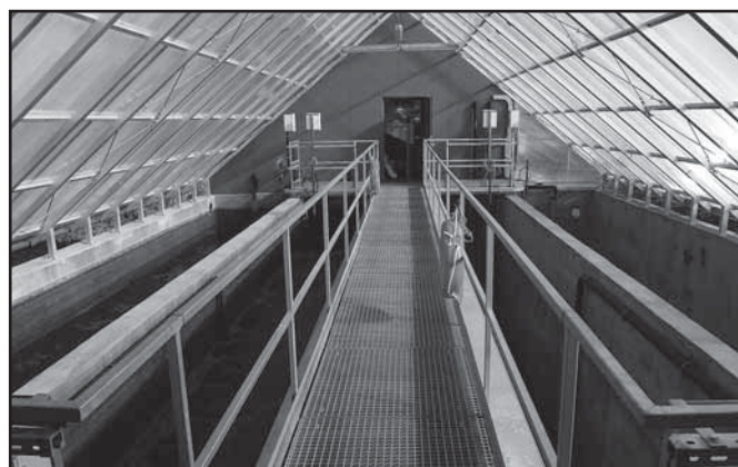
Szczurowa. Zmodernizowana oczyszczalnia ścieków.
