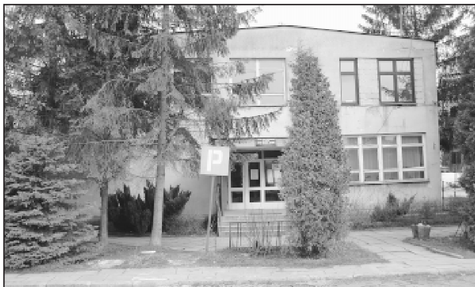
Budynek ośrodka w Szczurowej po latach użytkowania przez podległy Starostwu Powiatowemu w Brzesku SP ZOZ nadaje się do remontu.
